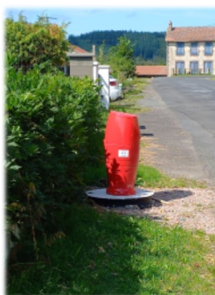
Pitelet Poteau incendie n° 13
