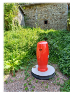
Pitelet Poteau incendie n° 14
