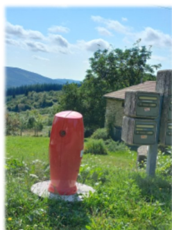
Le Thuel Poteau incendie n° 10
