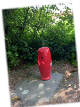
Tournaire Poteau incendie n° 6
