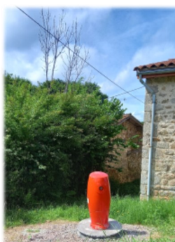
Dassaud Poteau incendie n° 7
